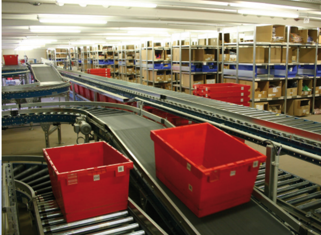
Bild 3 Für die Kommissionierung stehen auf zwei Geschoss-Ebenen jeweils rd. 5 000 m 2 Fläche zur Verfügung.
